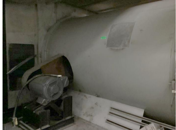
Rest room exhaust fan
